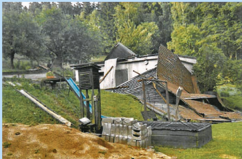
Poškozená střecha provozní budovy VD Vír, červen 2003 ↑↓
