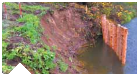
Na tomto snímku z výstavby je dobře patrné ohrožení stability silničního tělesa.
