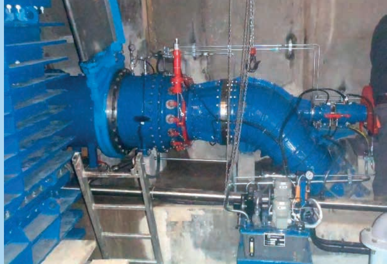
Kaplanova turbína na VD Plumlov ↑
