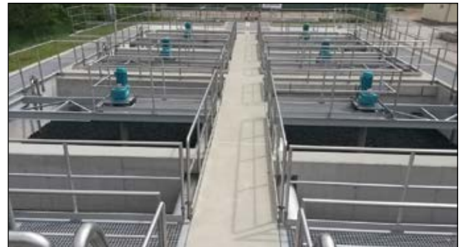
Obr. 1. Pohled na nádrže postdenitrifikační linky
